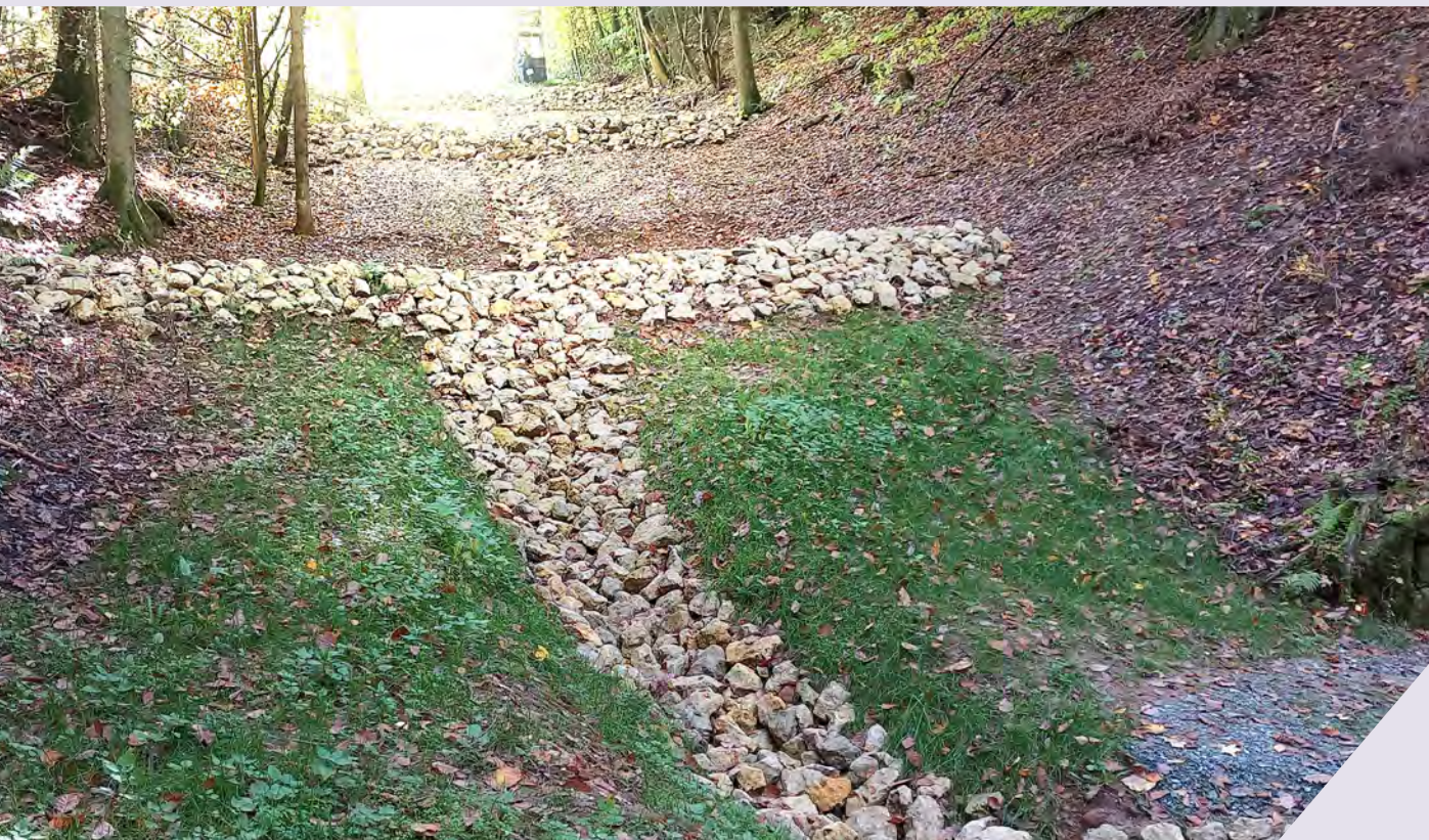
Das Foto zeigt eine kaskadenförmige Maßnahme zur Verzögerung des Oberflächenabflusses und den Rückhalt von Sediment im boden:ständig-Projekt Lautertal.
